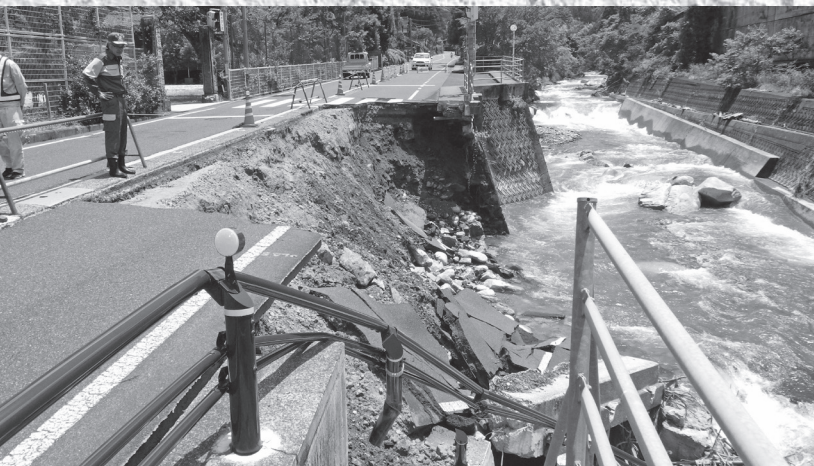
▲平成30年7月豪雨の被害により崩壊した護岸と道路
