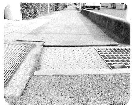
接着が剥がれ浮き上がった舗装
