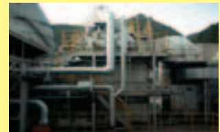
▲バイオマス発電プラント
